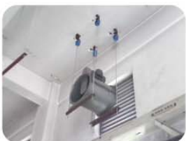
安装的耐高温排风机可以将热风直接排出室外
